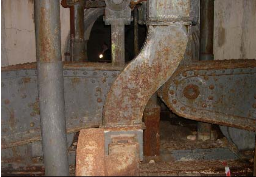
Système de ventilation
