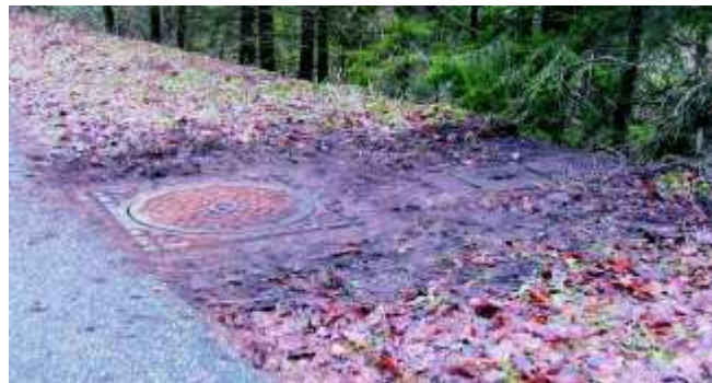
Vue d'une plaque de DMP en puit de type Pont-à-Mousson
