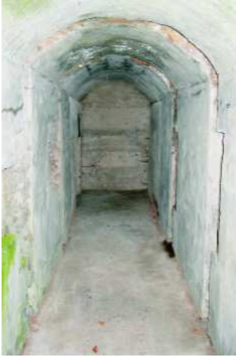
Vue intérieur du rameau, remarquer les gorges latérales pour les masques du bourrage
