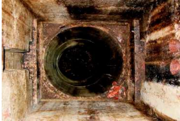
Vue intérieure du puit, remarquer les gorges latérales du masque et les gaines pour les cordons de mise à feu
