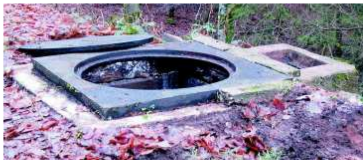
Vue d'une plaque DMP en puit du type « croix de lorraine »
